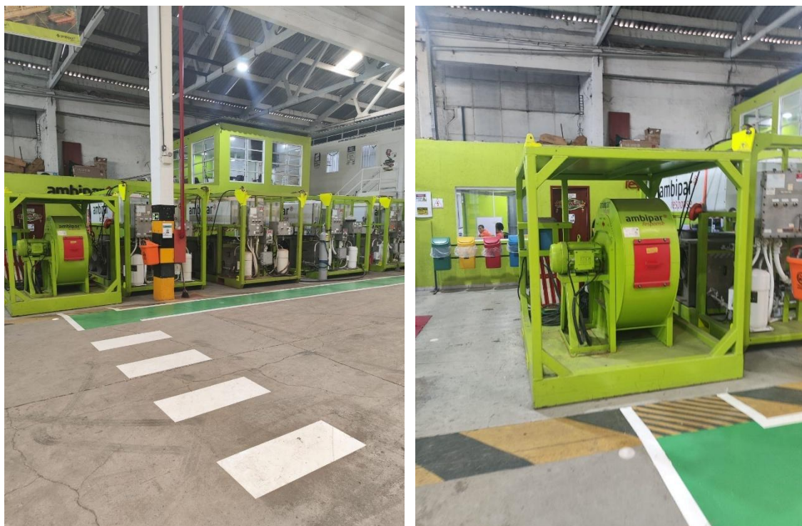
(Nas imagens, galpão de indústria e máquinas pesadas de ventilação)
